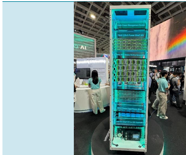
圖表 8：光寶科 Orv3 機櫃內整合式電源與散熱系統
